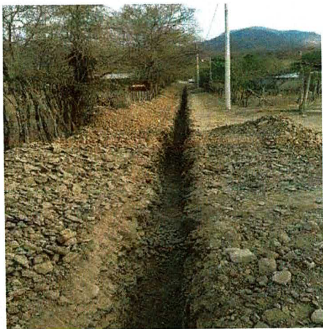
Drenaje sanitario con una longitud de 401 ML, ubicado en el municipio de Carácuaro de Morelos, Michoacán.
